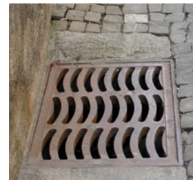
Grille d'évacuation des eaux de pluie
